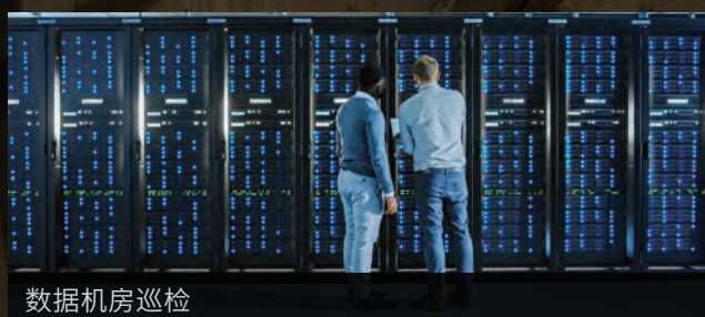
电气设备巡检
